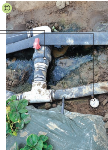
Mantenimiento del sistema
